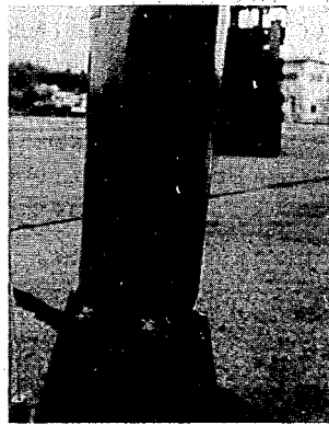
写真8.8 変形後の支柱基部の状況
