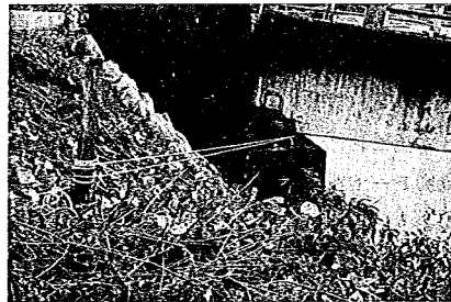
写真-2.3 睦橋左岸橋台の破損
