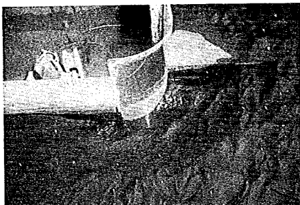
写真2.9 隅角部の洗掘結果
