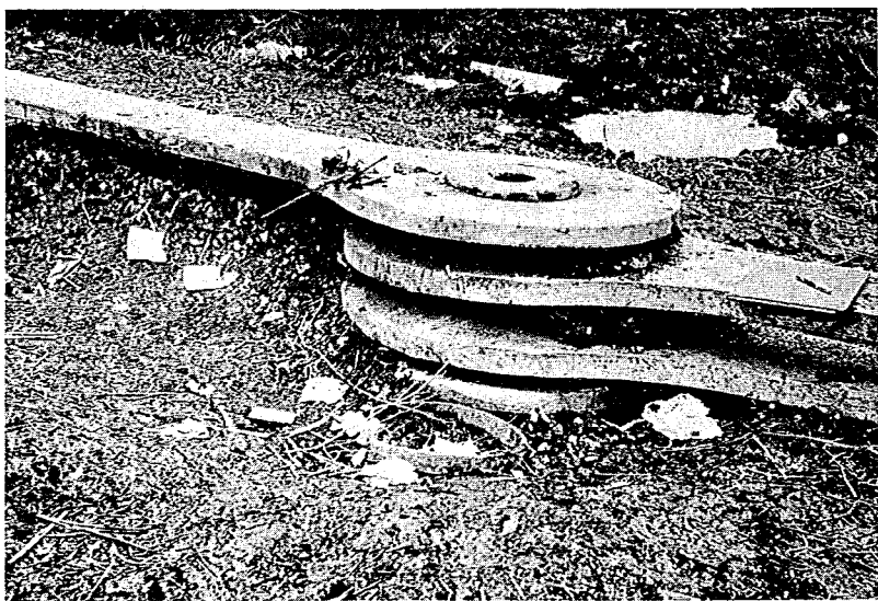
図 1. 2 崩壊したポイント・プレザント橋
