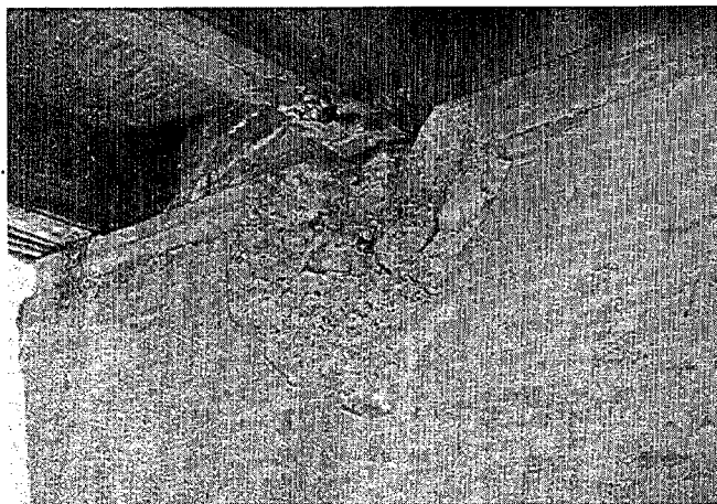
写真8-1 白田川橋（国道135号線） 橋脚のクラック
