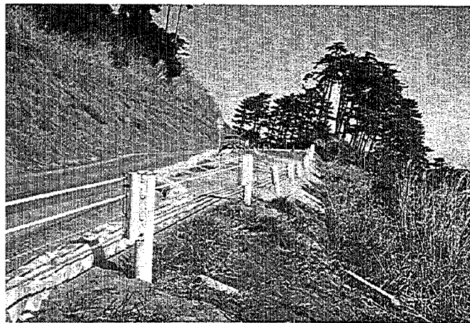
写真7-6 盛土の沈下（135号線，東伊豆町）
