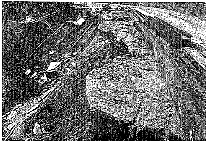
写真7-3 盛土の崩壊（修善寺下田線，梨本）
