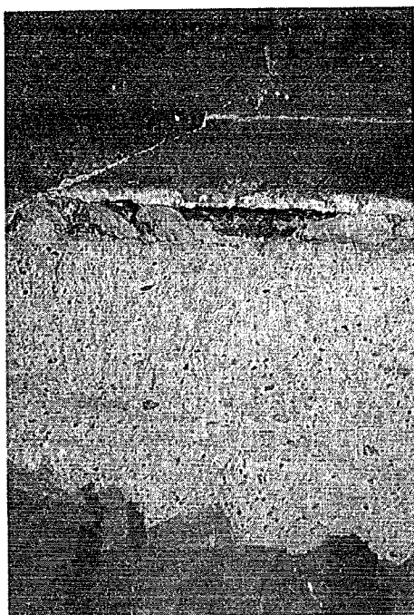
写真 8-8 側壁コンクリートの欠落 (友路トンネル)
