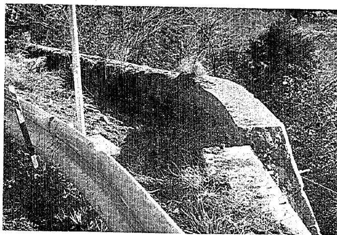
写真7-9 ブロック積擁壁のずれ（修善寺下田線，湯ヶ野）
