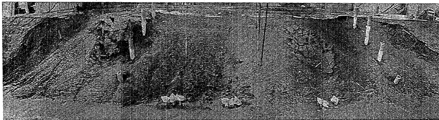
写真-6 降雨720 mm で中断したときの堤防
