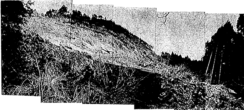
写真-3 別府-阿蘇有料道路の崩壊
