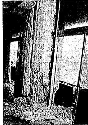
写真-6 九重レークサイドホテルの被害
