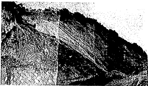
写真-4 東伊豆町白田地区の東伊豆有料道路の斜面崩壊
