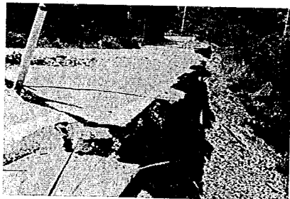
写真-3 沢に盛土した部分の道路崩壊（石廊崎付近）
