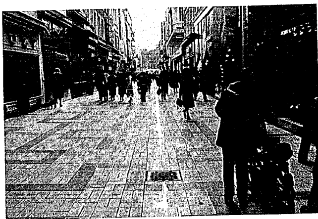
写真-4.40 リールの歩行者道路 道路中心に排水ますが設置されている。
