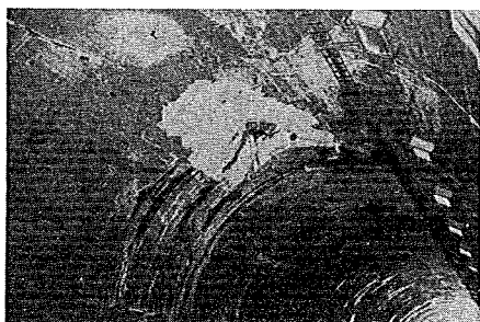
写真 4.3-6 友路トンネルのアーチ部の被害
