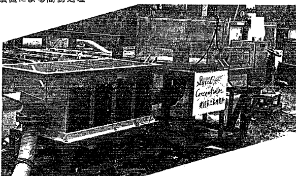
写真-1 スワール固液分離装置と量水槽
