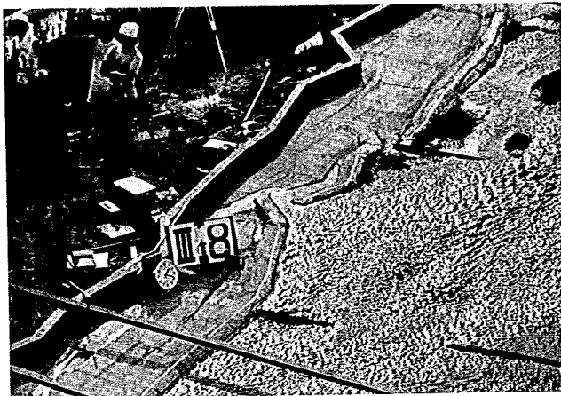
ケース 12 流量 800\text{m}^3/\text{s} 11.45k右岸新設かすみ堤氾 濫状況
