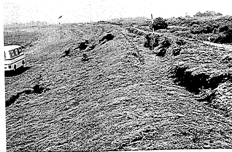
写真-6 吉田川堤防の沈下
