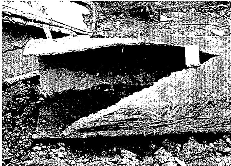
写真-11 破損した 400m の配水管 (仙台市向山 4 丁目)
