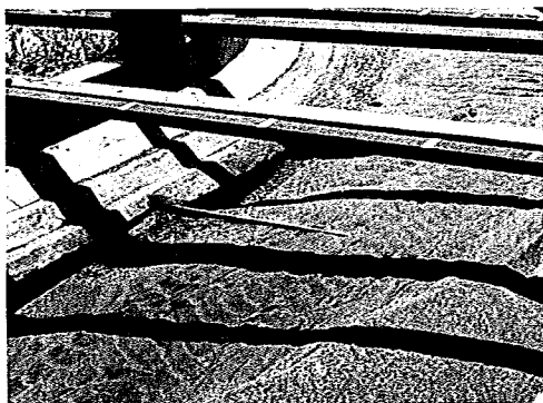
写真-28 1.3km落差工 <右岸側は土砂で埋没し効果なし>
