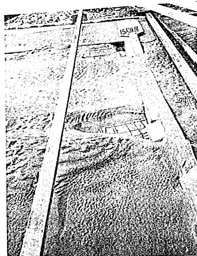
写真－3.2 床止工周辺の局所洗掘1)
