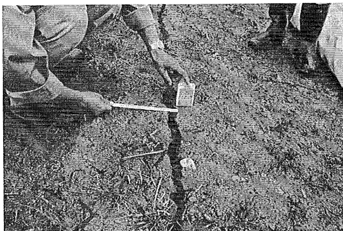
図-16 蒜但木ダム天端きれつ (その2)
