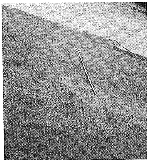
図-17 孫沢ダムのきれつ (その2)
