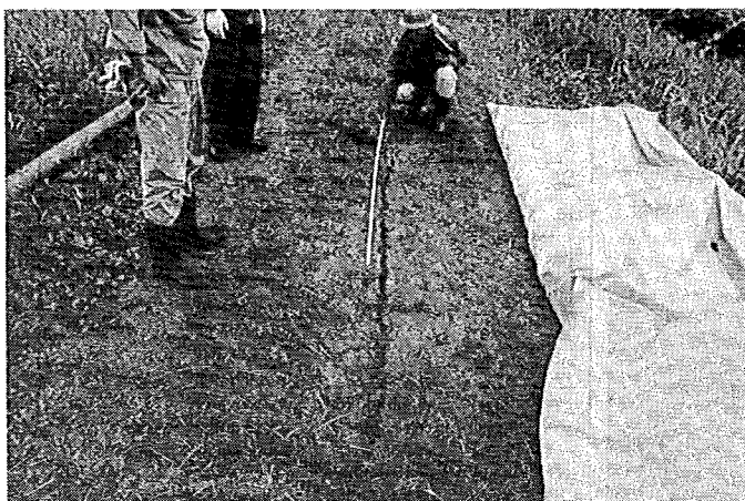
図-16 蒜但木ダム天端きれつ (その1)
