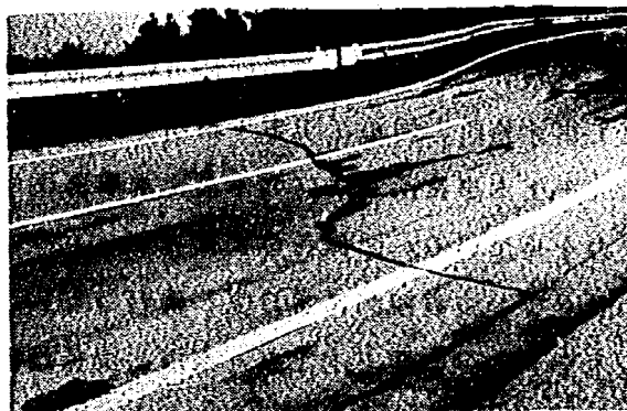
写真-3 盛土部の沈下・亀裂（三瓶山公園線）
