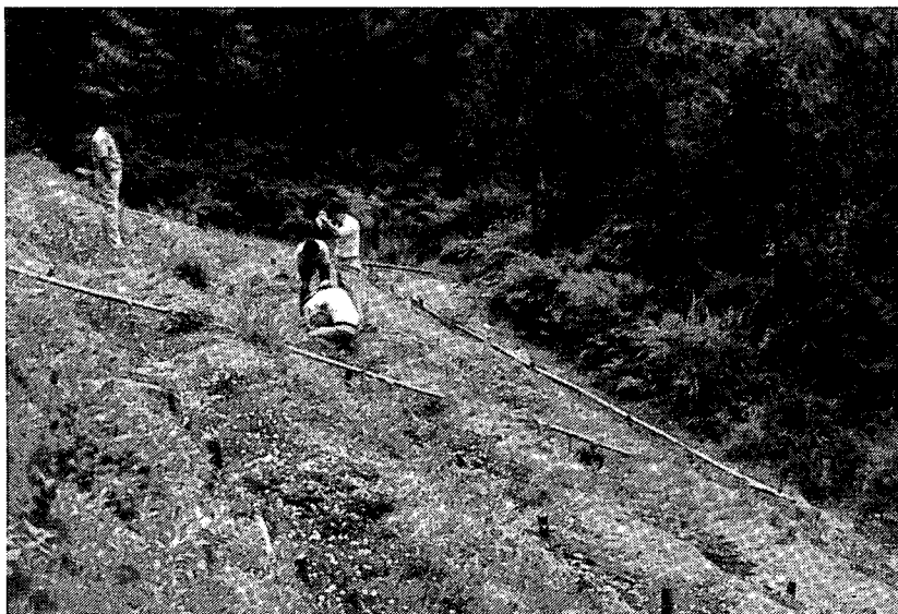
写真5. 山腹の傾斜地に設置した大型土壌処理施設（広島県）
