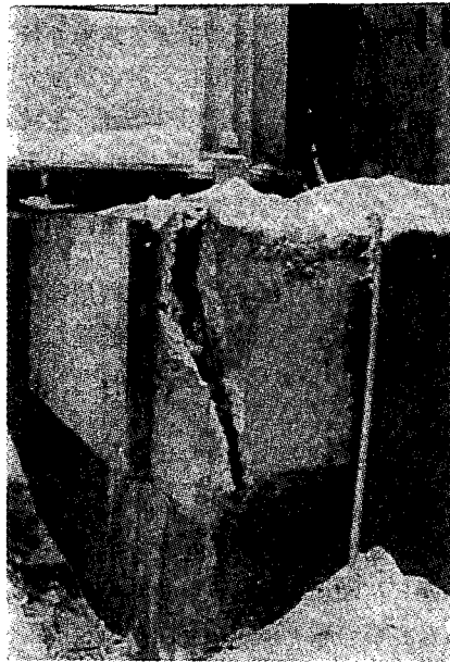
写真-3.1.1 橋台躯体コンクリートの破壊（錦桜橋）
