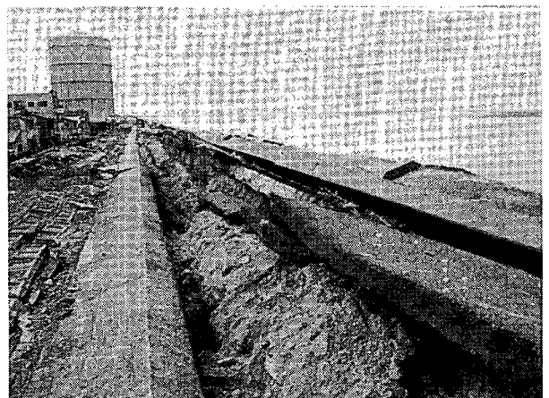
写真1 兵庫県南部地震における堤防の被災事例
