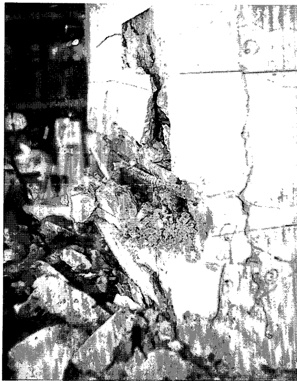
写真-参-2 かぶりコンクリートの剥離（ケース1）
