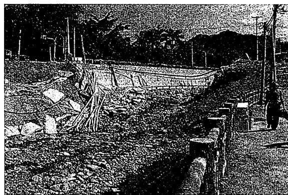
写真3.1-③ 河川擁壁の変状
