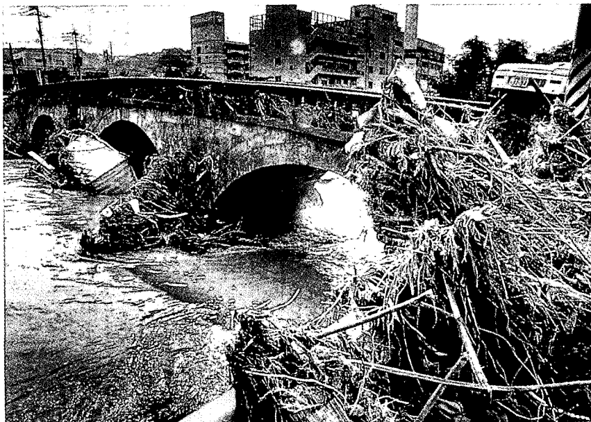
写真-4 93夏鹿児島風水害より鹿児島市玉江橋
