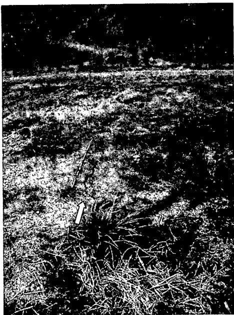
写真-3・24 造成地上の雁行亀裂 (⑤) 1~5m の亀裂がミ型に雁行する。
