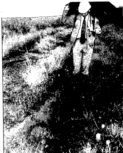
写真-7.2 弓浜干拓地中海側堤防天端のクラック
