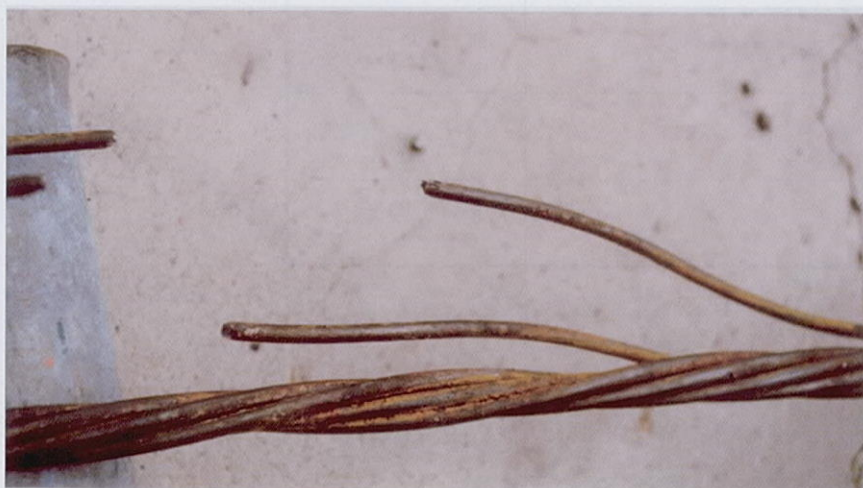
写真-3.5 破断箇所の腐食状況 (PC4)
