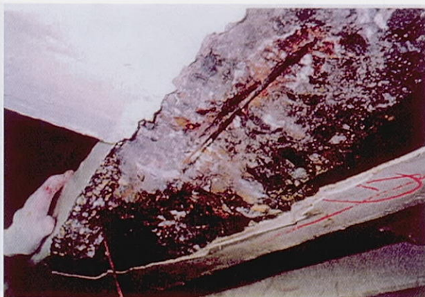
写真-15 G6 桁，写真-13 のはつり後(その2)
