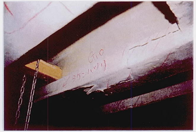
写真-16 G10 桁中央付近の再劣化
