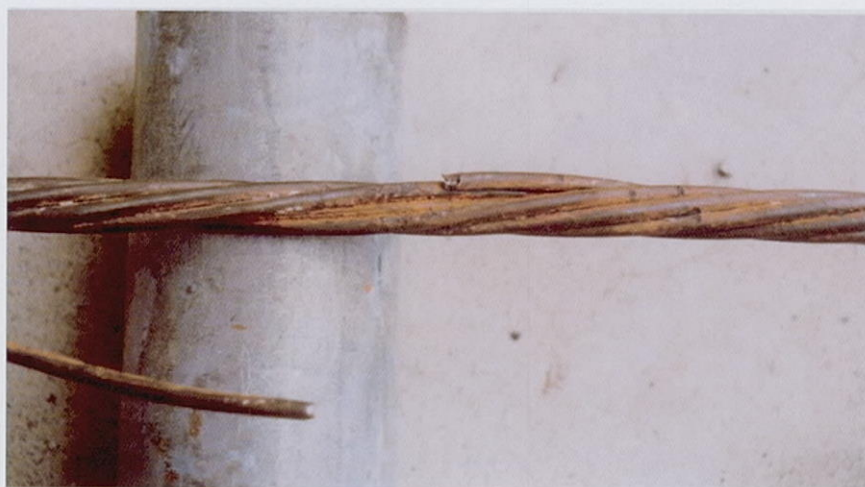
写真-3.6 破断箇所の腐食状況 (PC5)
