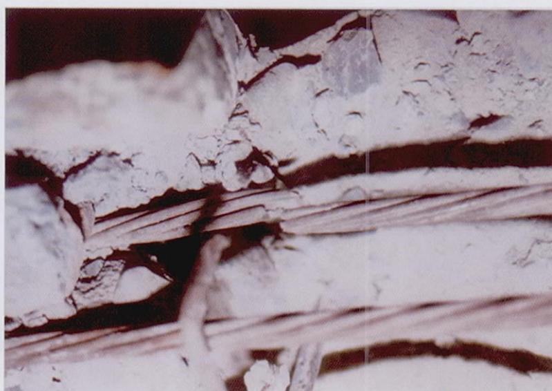
写真-6.2 B-1 の破壊箇所付近の腐食状況 (写真-6.1 の右側側面の PC 鋼より線 2 本)
