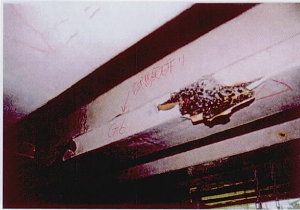
写真-13 G6 桁中央付近の再劣化，一部塗膜除去後
