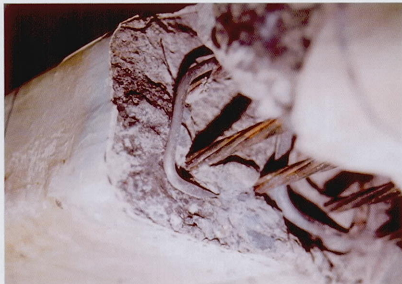
写真-6.4 B-2 の破壊箇所付近の腐食状況 (写真-6.3 の奥側)
