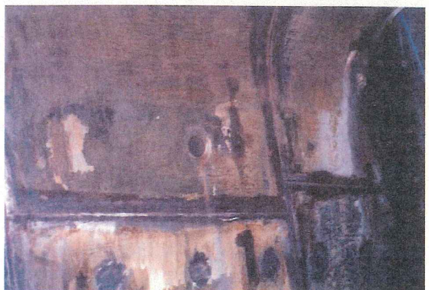
写真－１．４ ステンレスクラッド鋼の溶接ビードの腐食事例
