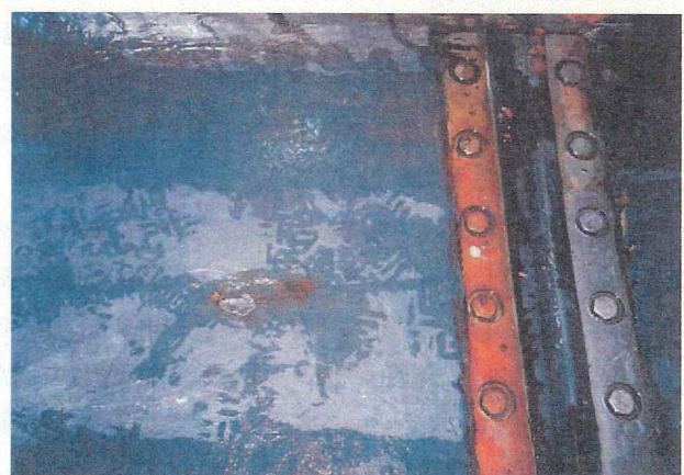
写真－１．２ 異種金属接触腐食の事例
