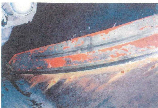
写真－１．３ 放流管の腐食事例
