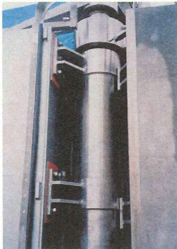
写真-7. 10 (a) アルミニウム合金材料の使用にあたり異種金属接触腐食を避けるために絶縁を施した例
