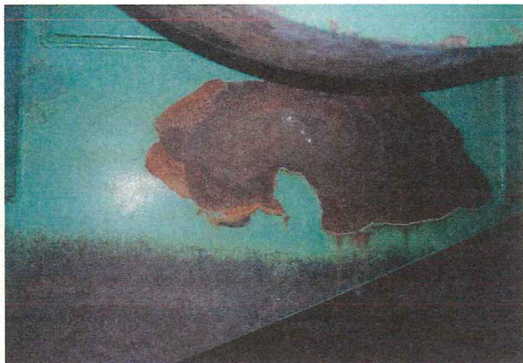
写真-7. 9 (a) 塗替塗装が困難な構造例
