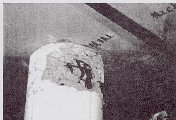
(b) 外側の杭の端部における損傷状況
