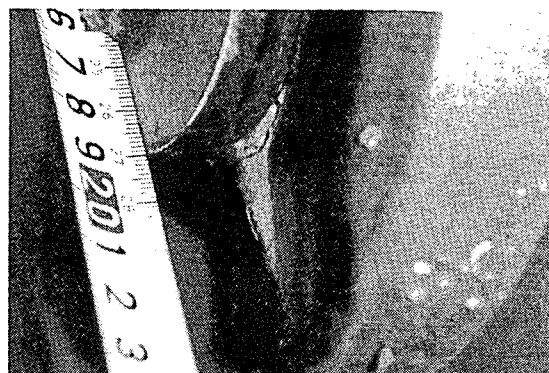
写真3 ローラ部錆こぶ外観
