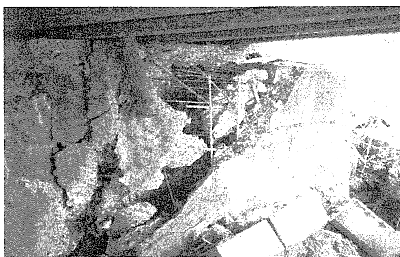
写真-4 東魚崎大橋の被災状況 11) (兵庫県南部地震)
