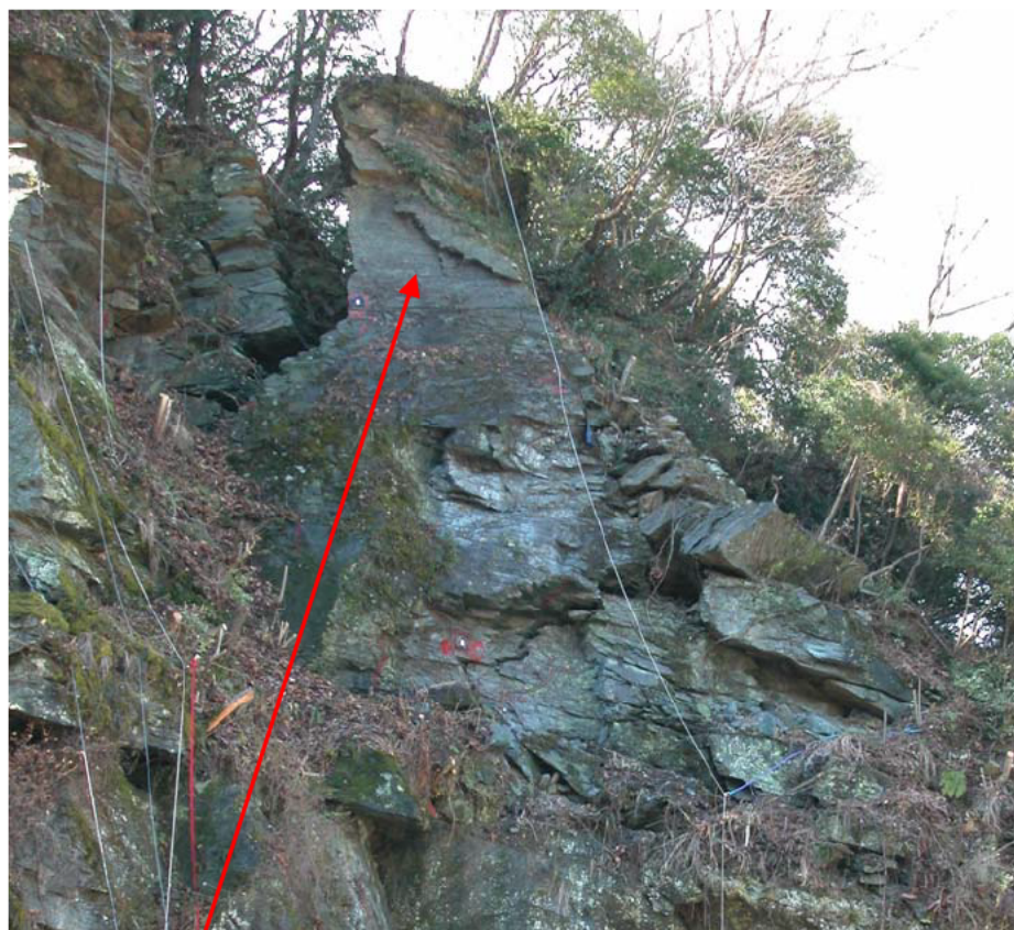
計測点P-13設置ブロック (側面)
