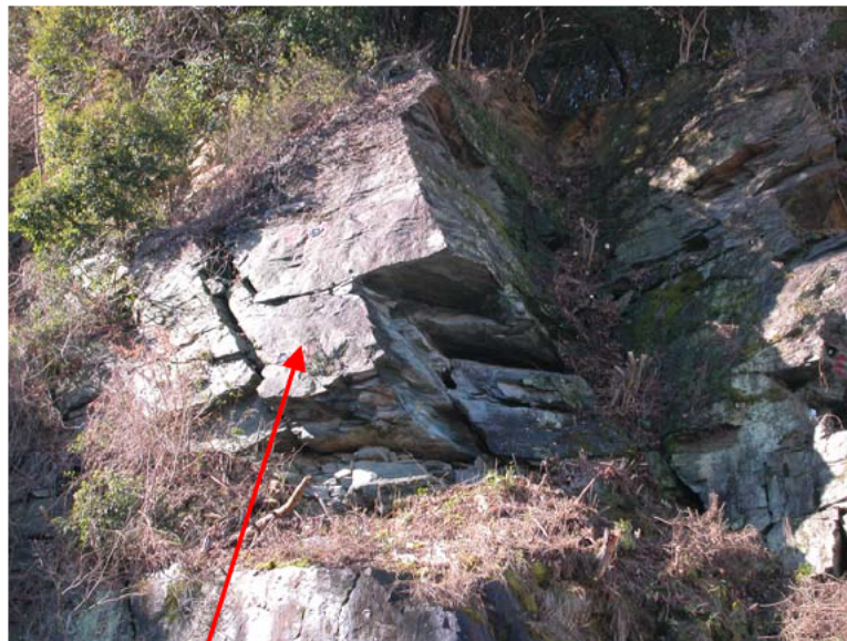
計測点P-3設置ブロック (側面)
