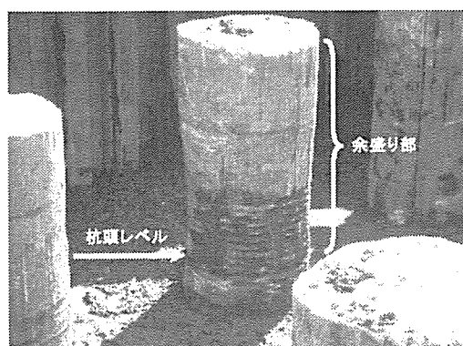
写真・付Ⅳ.1 杭頭部の細り状況
