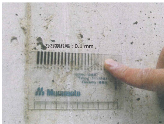
写真-5.15 近畿 A：P6 (30) のひび割れ状況
