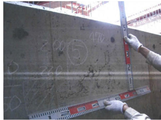
写真-5.14 東北 B：豆板発生状況
