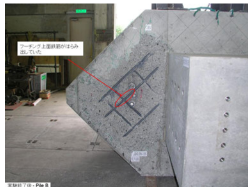
写真-5.8 Case F：試験終了時のフーチング上面 の損傷状況
