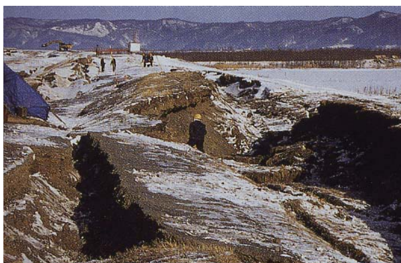
写真 2 1993 年釧路沖地震における十勝川統内築堤の被災状況
