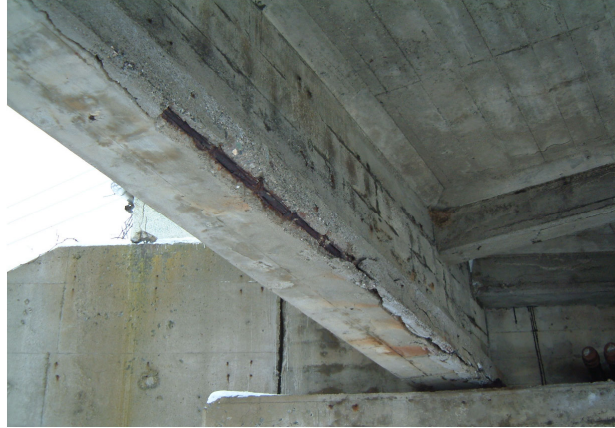
解説 写真-2.2.1 桁の下面における塩害による劣化事例
