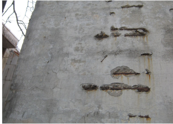
解説 写真-2.2.2 かぶりの薄い箇所における中性化による劣化事例
