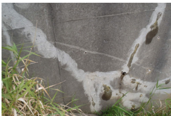
ひび割れ注入後（10ヶ月後）の漏水と析出物
