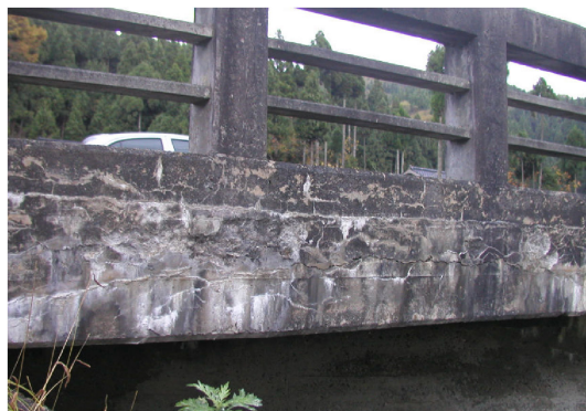
解説 写真-2.2.4 雨掛かりのある箇所でのアルカリシリカ反応による劣化事例
