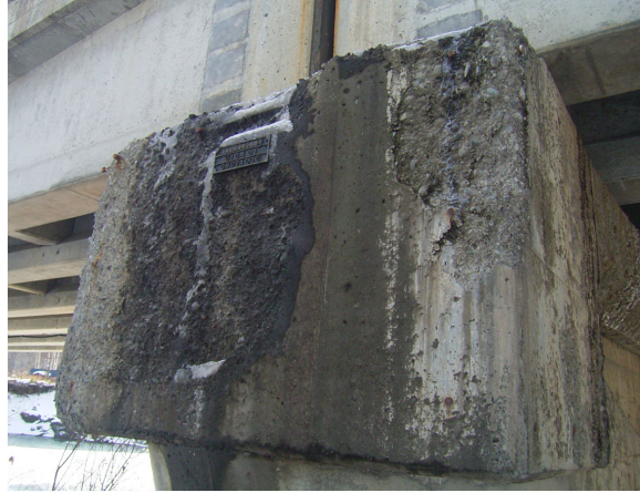
解説 写真-2.2.3 橋面排水が流下する箇所の凍害による劣化事例
