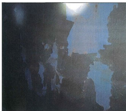
解説 写真-3.2.1 気体の水分（水蒸気）の結露が要因となり発生した塗膜の剥離〔被〕
