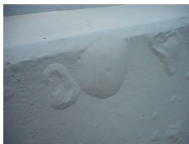
a) 浮き, 膨れ
