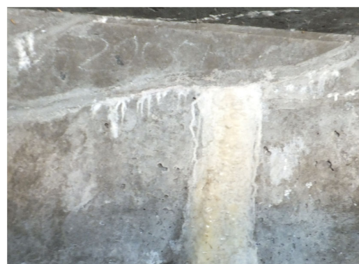
ひび割れ充填後（約1年後）の析出物
