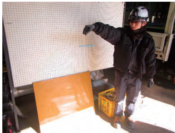
写真-5.11 第1段階 (鉄筋落下)
