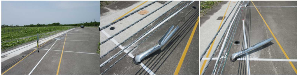
写真-4.7 乗用車衝突後の支柱の損傷状況
