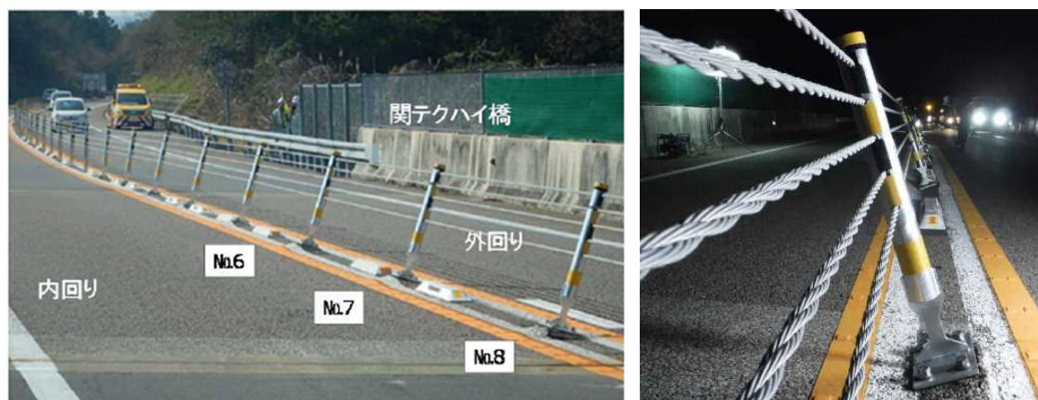
写真-2.3 傾倒事象発生状況
