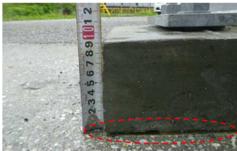
写真-2.6 支柱5のコンクリート基礎の浮き
