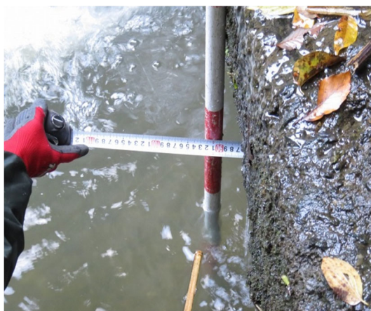
写真-10 底版直下の洗掘の例
