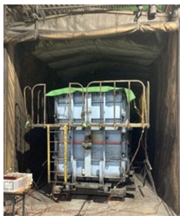
写真-5 蒸気養生設備の正面写真
