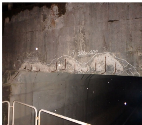
(a) コンクリートのうき・剥離および鉄筋露出
