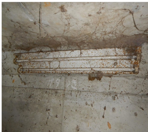
写真-3 照明器具の腐食の例
