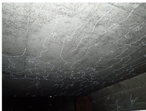
写真-1 亀甲状のひびわれの例
