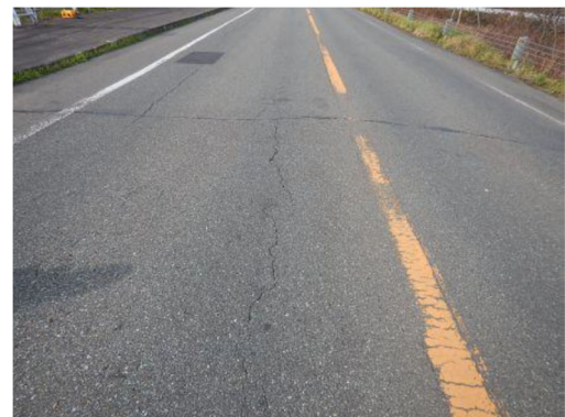
(b) 上部道路縦断方向も含む亀裂
