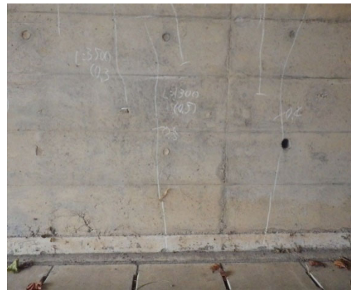
写真-2 側壁の鉛直方向ひびわれの例
