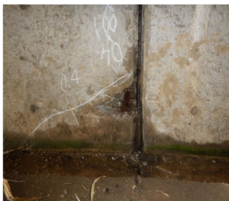
(b) 継手部からの土砂の流入
