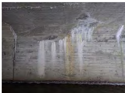
(a) 貫通ひびわれや打継目からの発生が考えられる漏水
