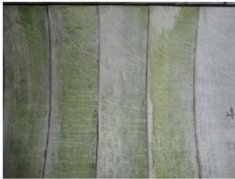
(a) ヒンジ式アーチカルバート側壁のひびわれの例
