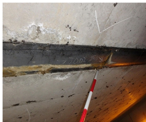
(a) 導水工の破損による漏水
