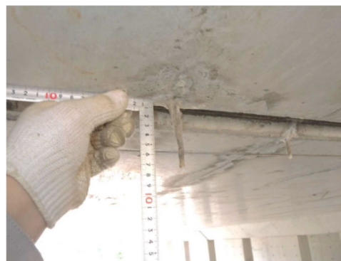
(f) 氷柱状の遊離石灰の例
