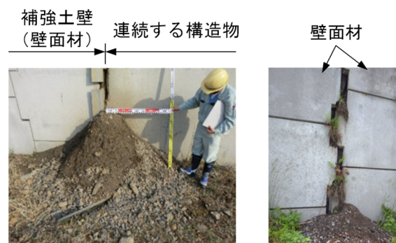
図-1(b) 盛土材の漏出の事例（左：連続構造物接続部、右：壁面材どうしの接合部）
