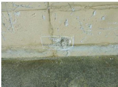
写真-4 コンクリート欠損の例
