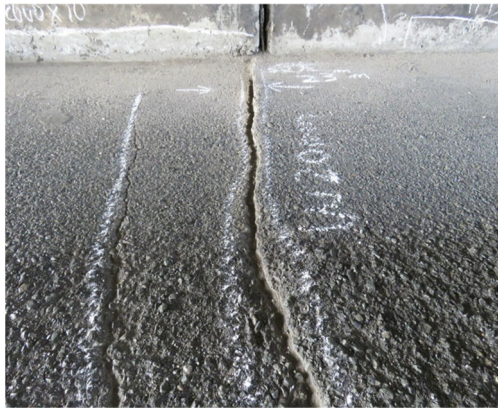
(a) 継手位置に沿った亀裂・段差
