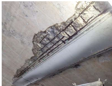
(d) 導水工付近の剥離・鉄筋露出
