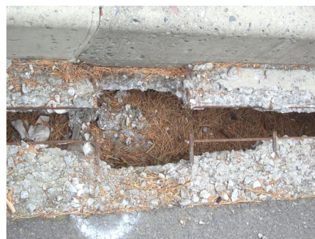
写真-4 DEFによって劣化した側溝の事例 7)
