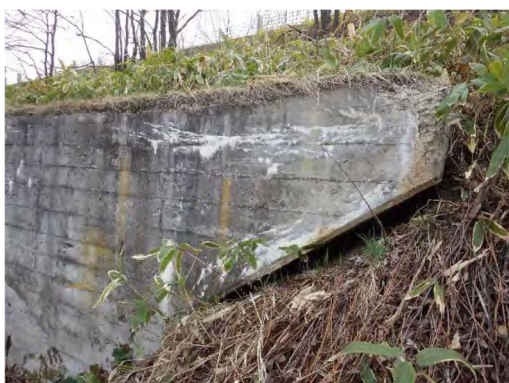
(c) 盛土とウイングの隙間
