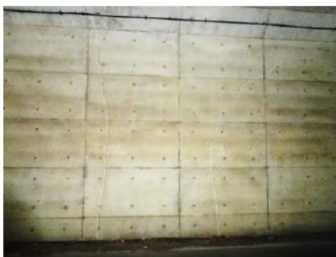
(e) 水分が流入したコンクリートの例
