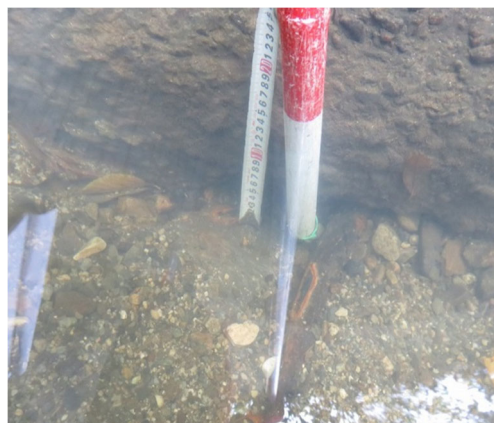
写真-8 底版直下の洗掘による空洞
