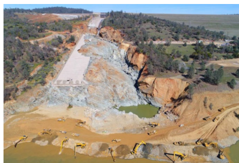
2017年の Oroville dam における常用洪水吐きの損壊 (事故調査の報告書 1) より抜粋)
