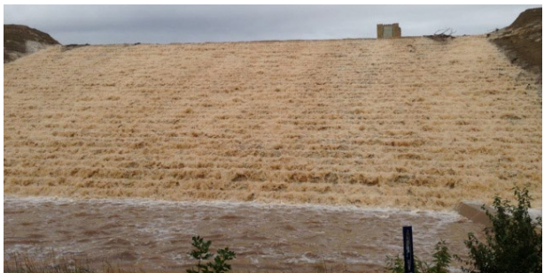
図-5 Left hand valley dam : RCCで階段状に保護した堤体下流面からの流下状況 3)
