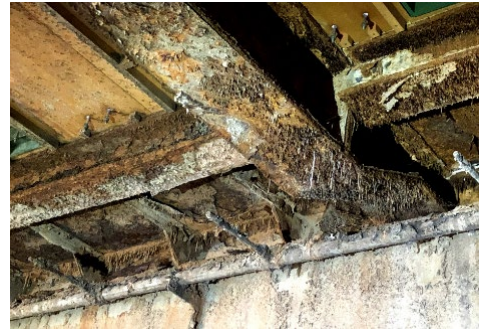
図-1 汚泥貯留槽の蓋を支える梁腐食
