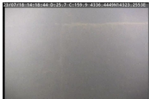
図-1 ROVにより撮影した堤体コンクリート（水深26m付近。カメラから堤体までの距離0.1m程度。水の濁りがひどく、近接しなければ何も見えない）
