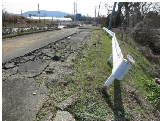
図-2.1 盛土変状箇所
