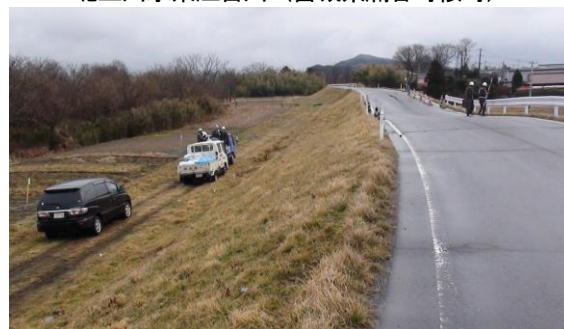
写真 3.4 堤防の被災事例（深部液状化） 1) 北上川水系旧北上川（宮城県石巻市）
