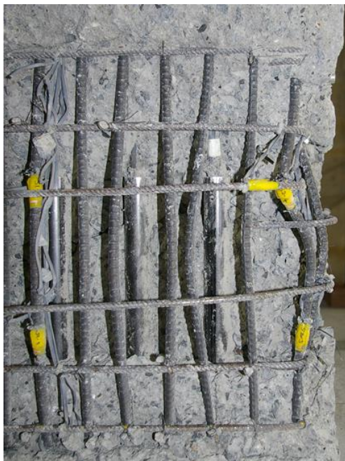
(b) コアコンクリートの損傷(A面付近を拡大)
