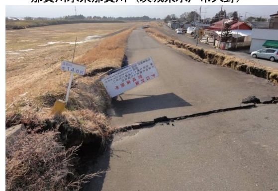
写真 3.3 堤防の被災事例（堤体液状化） 1) 北上川水系江合川（宮城県涌谷町桜町）
