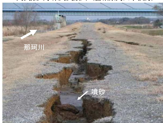
写真 3.2 堤防被災事例（堤体粘性土） 1) 那賀川水系那賀川（茨城県水戸市大野）
