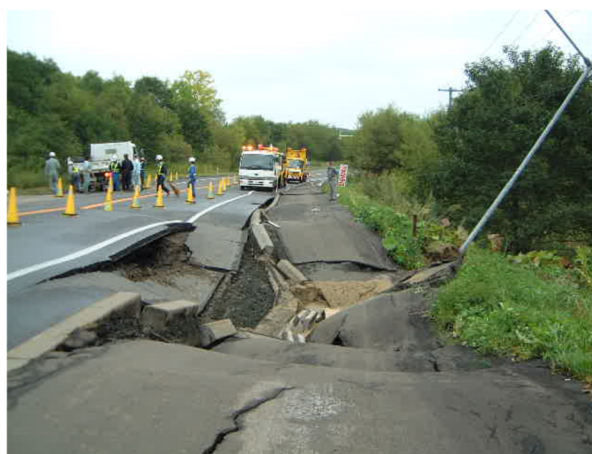
写真-1.2 2003年十勝沖地震における道路盛土（釧路町）の被災状況 2)
