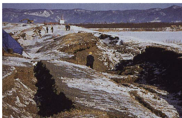
写真-1.1 1993年釧路沖地震における河川堤防（十勝川統内築堤）の被災状況 1)
