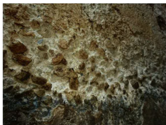
図 4 循環式硝化脱窒法を採用している処理場における劣化例
