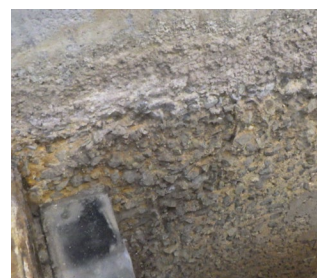
図3 疑似嫌気好気法を採用している処理場における劣化例（反応タンク嫌気槽）
