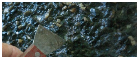
図2 酸素活性汚泥法を採用している処理場における侵食性遊離炭酸によると推測される劣化例
