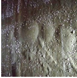
図6 防食被覆層の劣化事例（膨れ）
