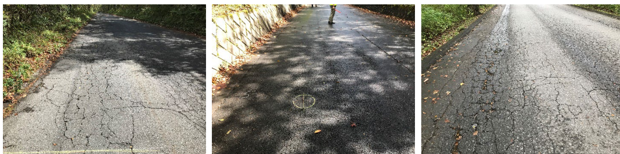
写真 6.1.1.1 舗装の破損状況
