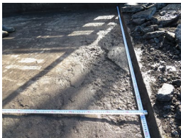
③ 表面劣化
