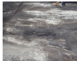
② ひび割れ
