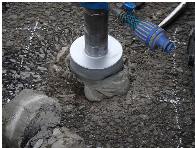
写真-3.5.4 Core-02 削孔時に析出したモルタル成分
