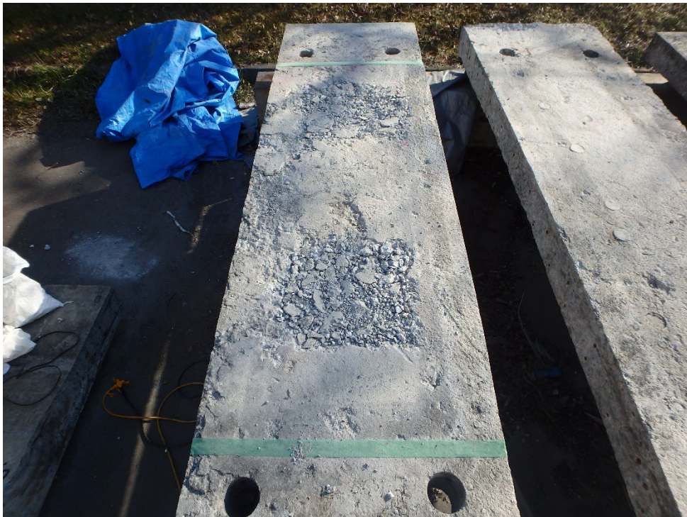
写真-5.1.9 はつり箇所にはつりがらを敷き詰めた状況（撤去床版活用供試体 No.2）
