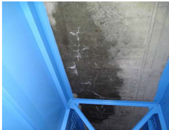
写真-3.1.3 遊離石灰（床版下面損傷区内の写-46）
