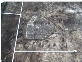
① 床版補修痕
