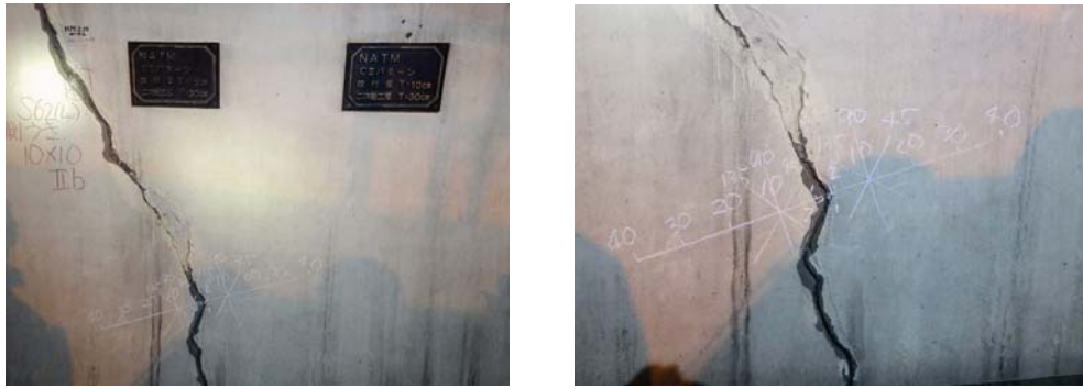
写真-4.1.3 変状が生じている箇所の測定箇所【S062】の状況
