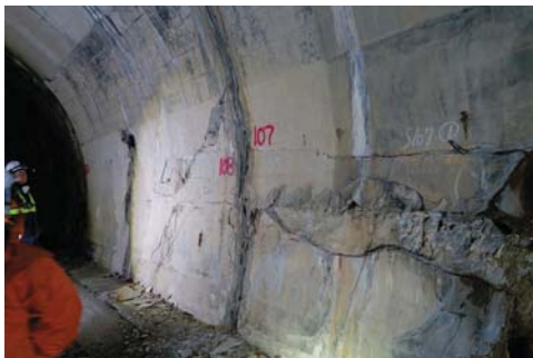
(e) 覆工表面のはく離 (S107)
