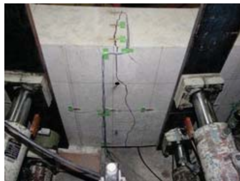
(b) 外面側 45° 付近のひび割れ
