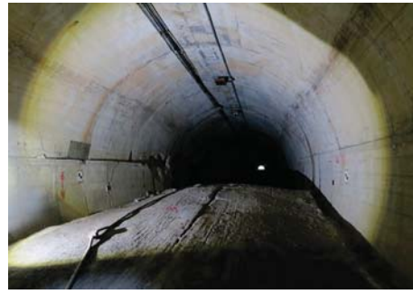
(b) 盤ぶくれ部 (区間③ : S52-1) (東坑口側から撮影)
