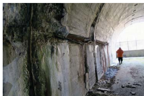
(f) 漏水 (西坑口付近)
