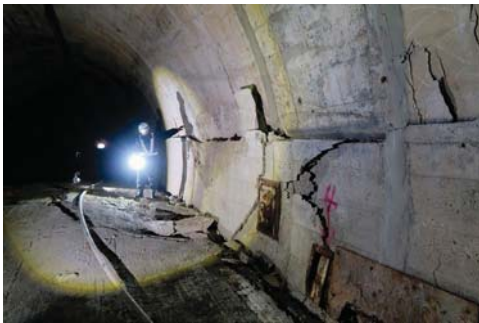
(c) 盤ぶくれ部 (区間③ : S52-1) (西坑口側から撮影)
