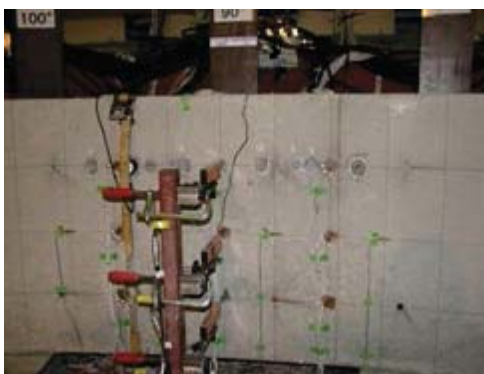
(a) 内面側 90° 付近のひび割れ
