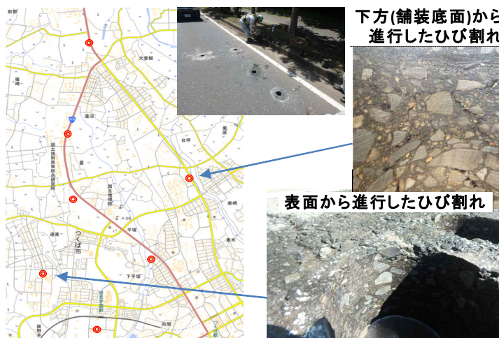
図-6 ひび割れ形態の異なる破損（つくば市内試験舗装区間）
