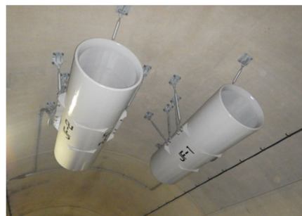
写真-1 換気用ジェットファンの取付状況の例
