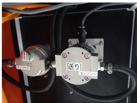
図-30 燃料流量計の設置状況
