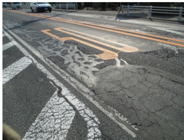
写真-1 修繕工事現場の路面状況
