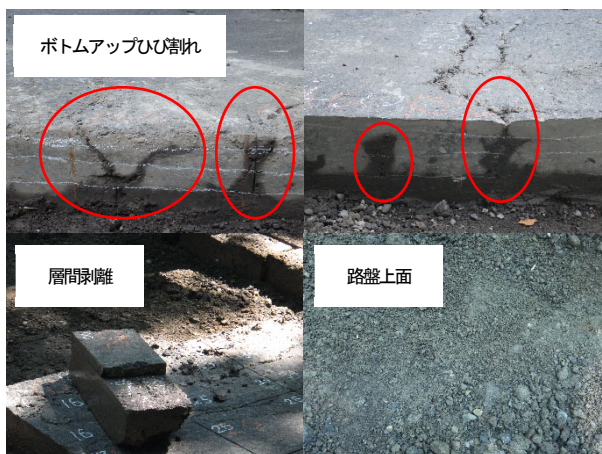
写真-7 ボトムアップ疲労ひび割れ、層間剥離 および下層路盤上面の状況 (OWP)
