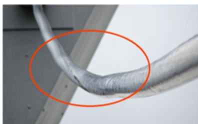
写真-7 損傷したケーブルのよれ
