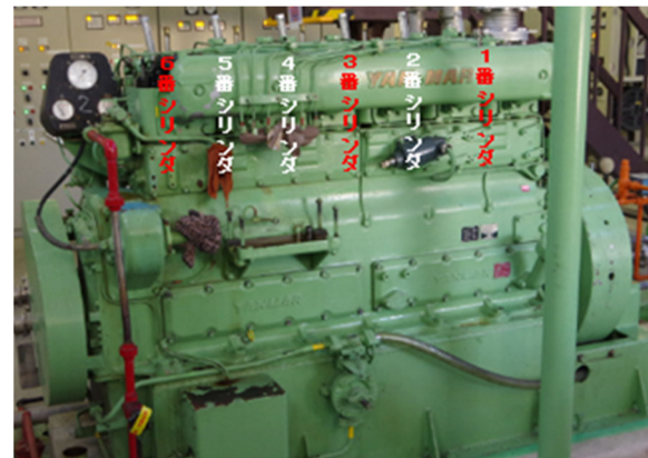
写真-12 S排水機場原動機全景
