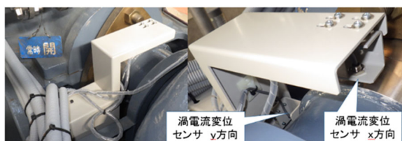
写真-21 Y排水機場1号主ポンプ
