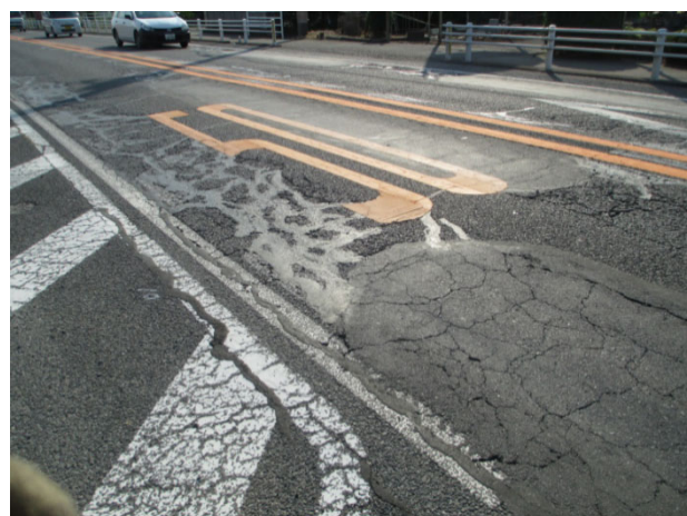
写真-1 修繕工事現場の路面状況
