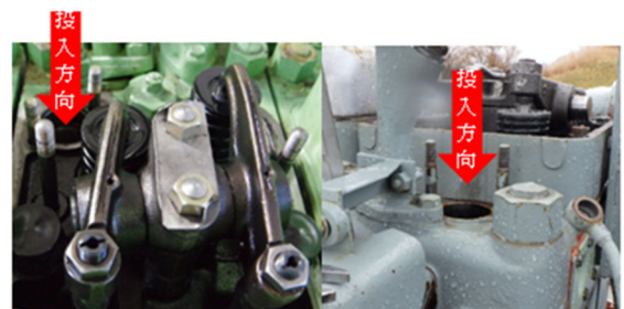
写真-13 内視鏡投入箇所
