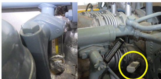
写真-1 配管干渉 写真-2 目盛面不備
