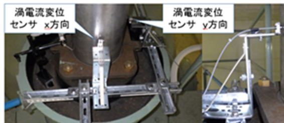
写真-18 S排水機場1号主ポンプ
