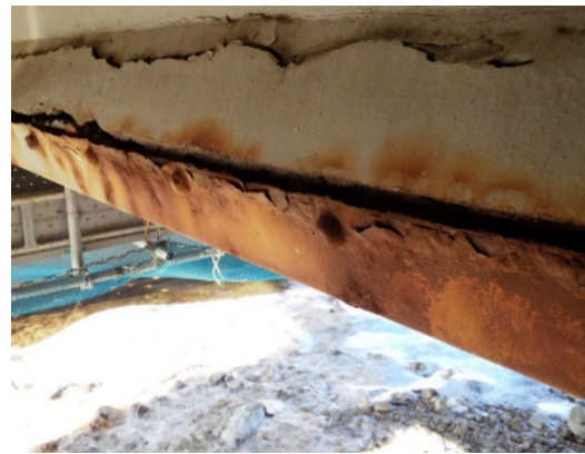
写真 1.4.4 構造本体の塩害による鋼板の剥がれ（損傷例）
