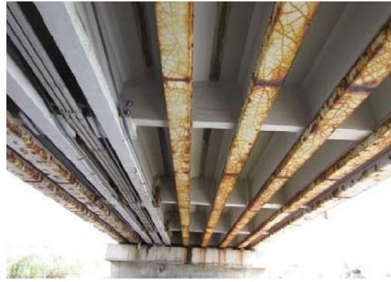
写真 1.4.2 鋼板自体の腐食（劣化例）
