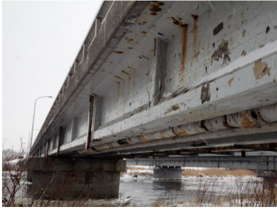
写真 1.4.1 紫外線による塗膜の変質（劣化例）
