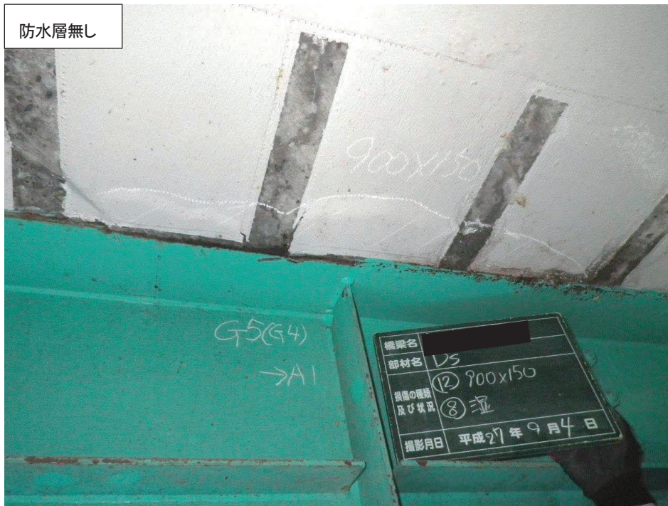
(i) 端部のみ剥離 (その1)
