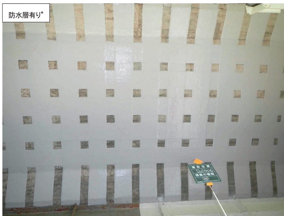
(b) 全面的に見られた浮き *2009年に防水工 図-2.2.5 連続繊維シートの変状事例 (格子貼り)
