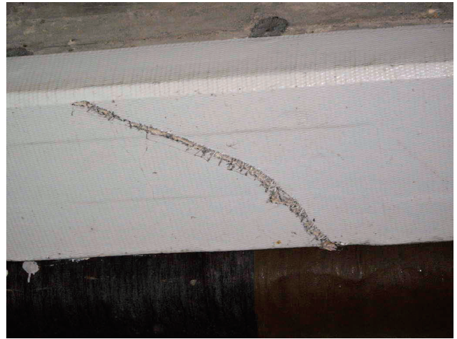
(b) 連続繊維シートの供用後の引っかき傷
