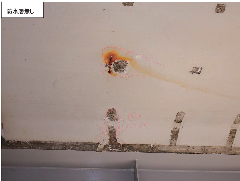
(h) ハンチ部の剥離
