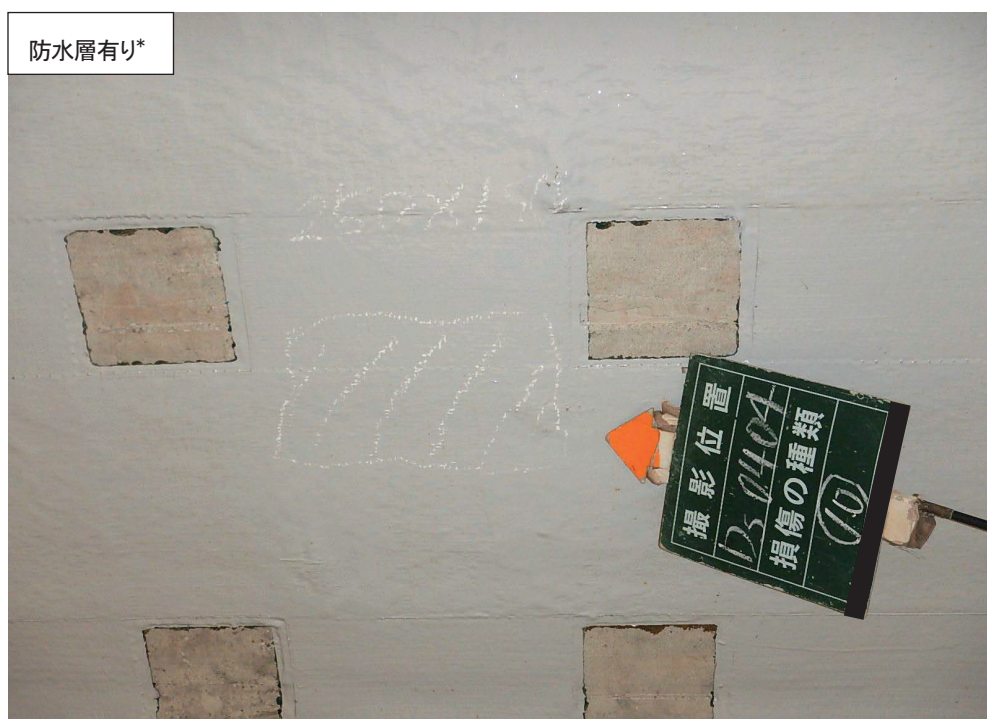
(d) 交差部と一般部の境目の浮き *2009年に防水工 注) チョークによる網掛けで浮きの範囲を示す。
