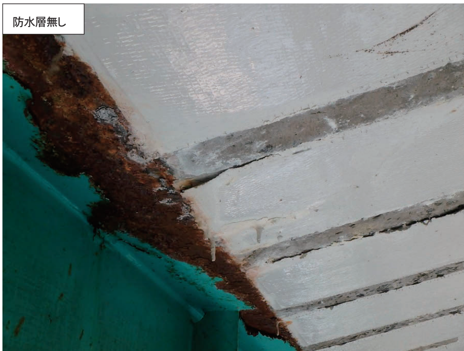
(j) 端部のみ剥離 (その2)
