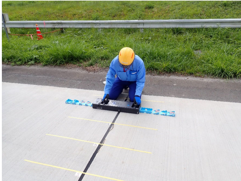
写真-6.4 検査装置センサ3をダウエルバーに合わせて設置する
