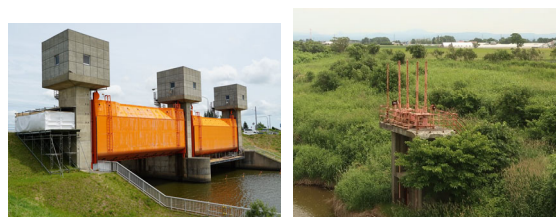
写真-2 高彩度色で塗装された土木施設。塗装ムラや錆などの影響が顕著に表れる
