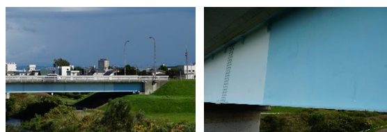
写真-3 補修時に部分的に再塗装された土木施設
