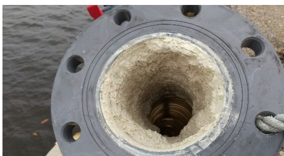
写真 11 水流生成装置管路内の実験後状況
