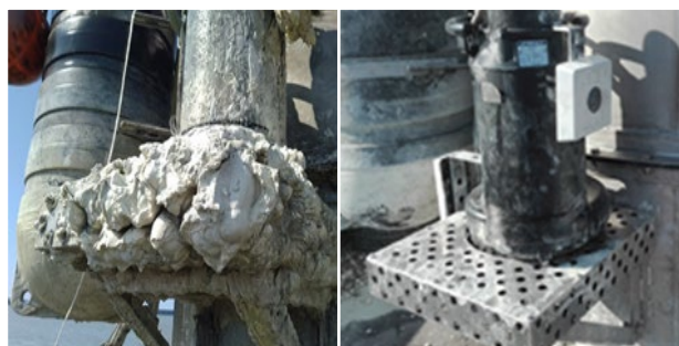
写真 4 吸水口の閉塞状況 (左：EL-9.0 m で 1 年稼働後、右：設置時)
