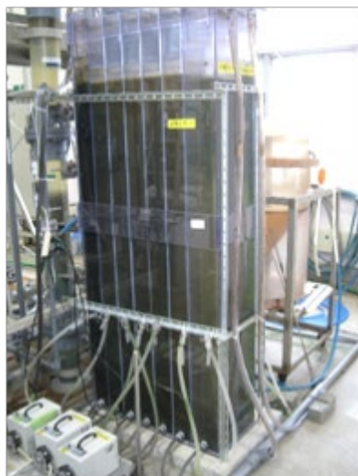
写真-5 簡易沈殿処理装置
